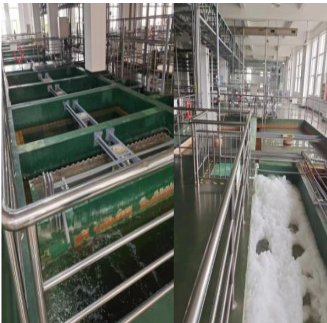
架高污水处理槽
