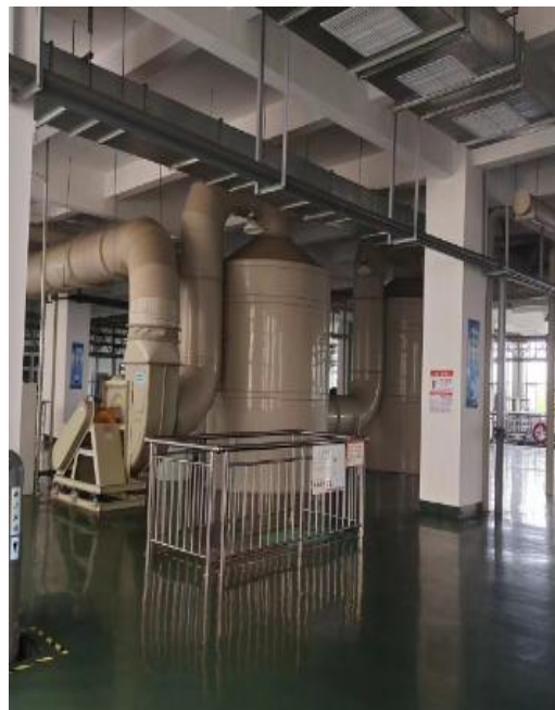
废气处理系统
