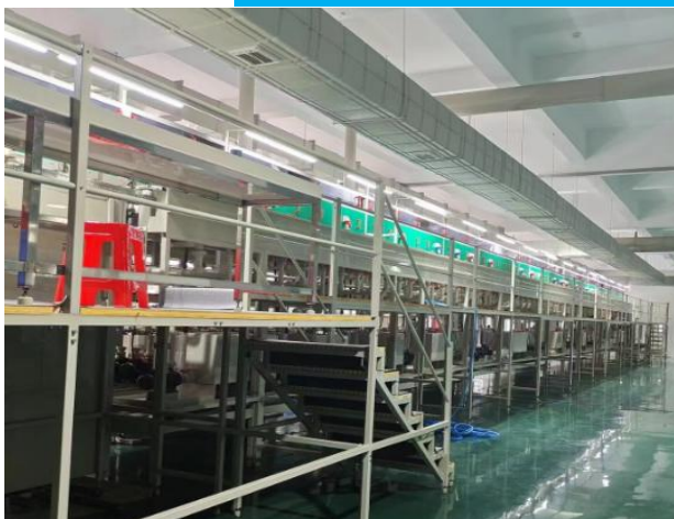
线体防泄漏架高，便于后期维护
